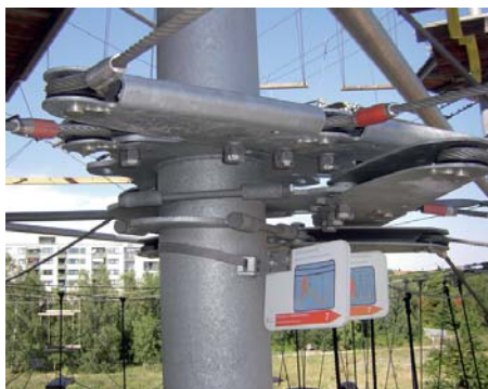
TÜV-geprüfte Befestigungen der Sicherungsseile auf dem Kletterturm: wartungsaufwändige, kostenintensive Technik für die Sicherheit der Besucher
